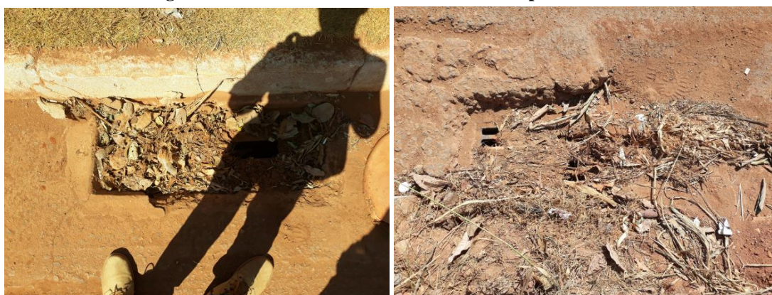
Figura 25 - Bocas de lobo obstruídas no município de Cabixi
